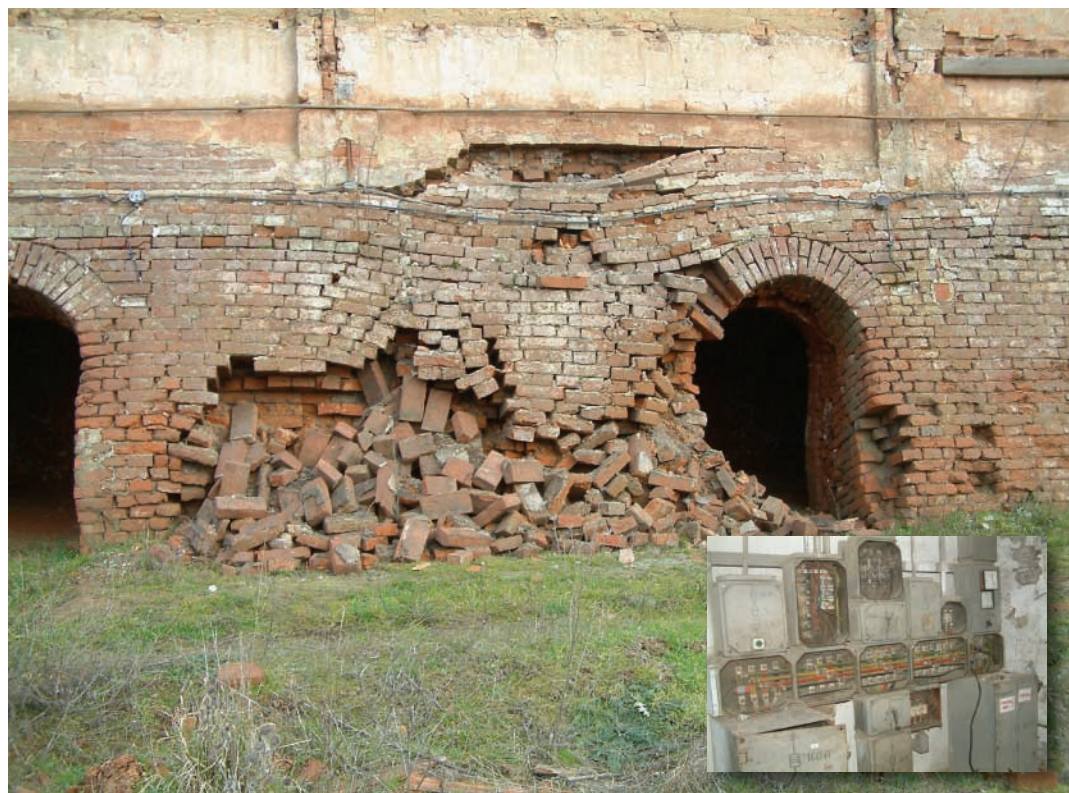
Az égető épület falai bedőltek. A kisképen a kapcsolórendszer „maradványai”
